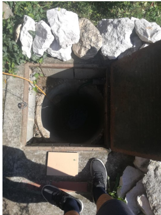
Köztes akna, szivattyúval
