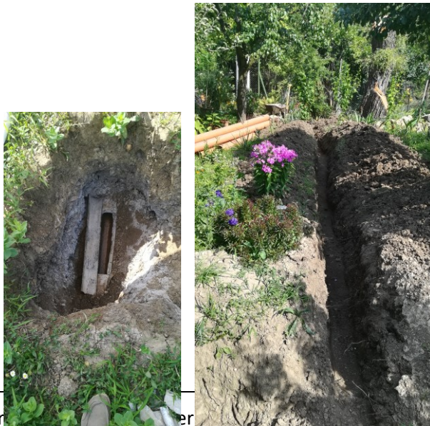
Telkeken átvezető régi vízvezetékcső feltárása
